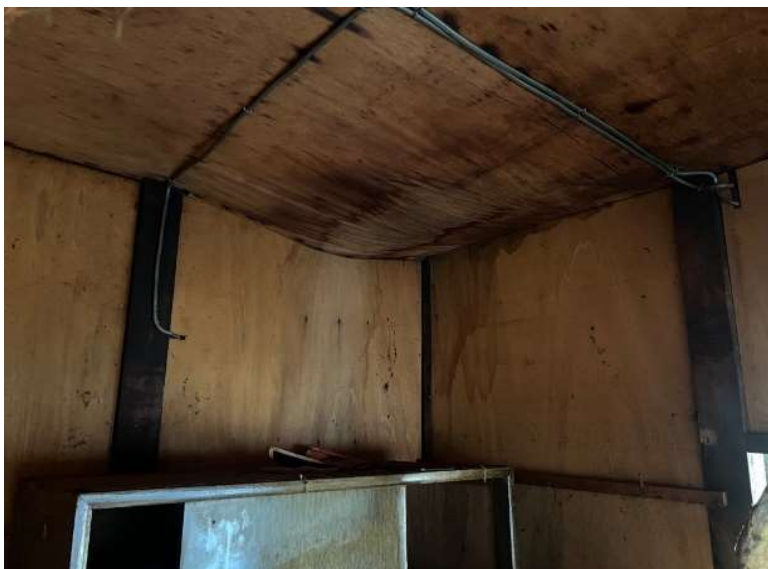
⑧対象土地物件内 中心部屋天井部分 歪みあり
