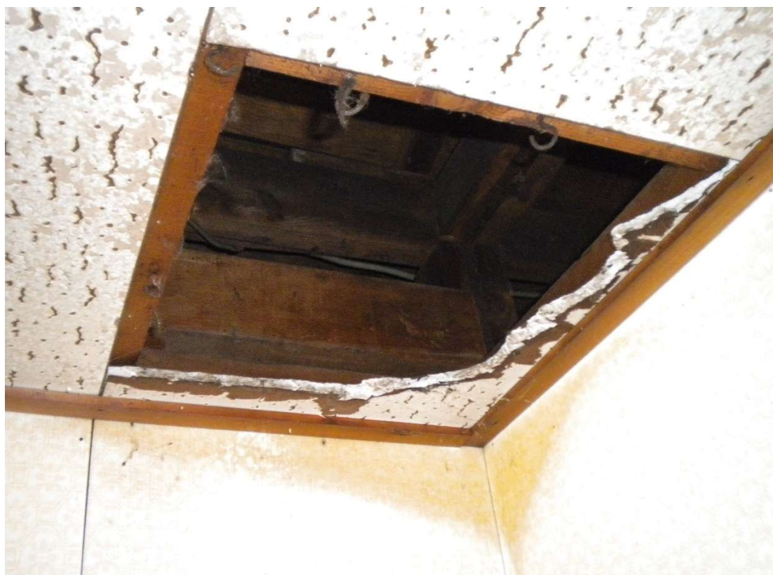
⑥玄関口左 天井部分に穴あり
