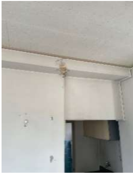
㊴対象個所に雨漏り？の形跡あり
