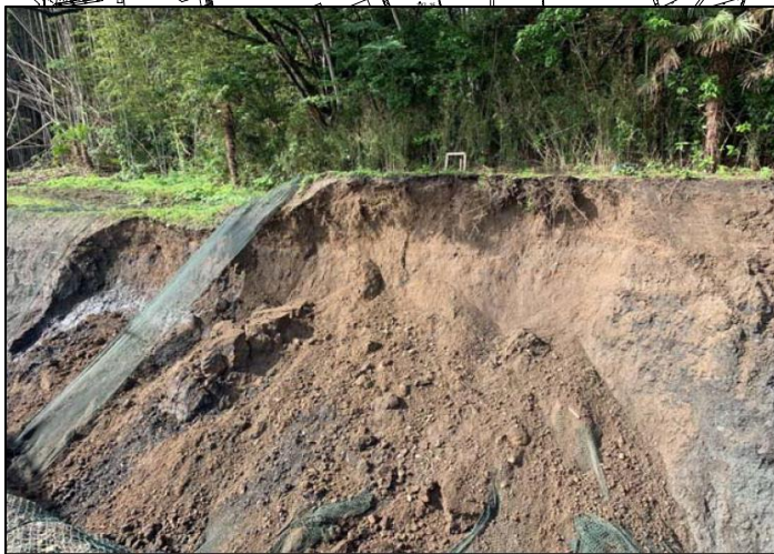
護岸工掘削時崩落状況（No.67付近）
