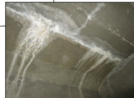
④現橋損傷状況 （上：支承部の腐食、下：床版ひび割れと遊離石灰）
