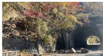
【国道300号の落石状況(R5年11月)】
