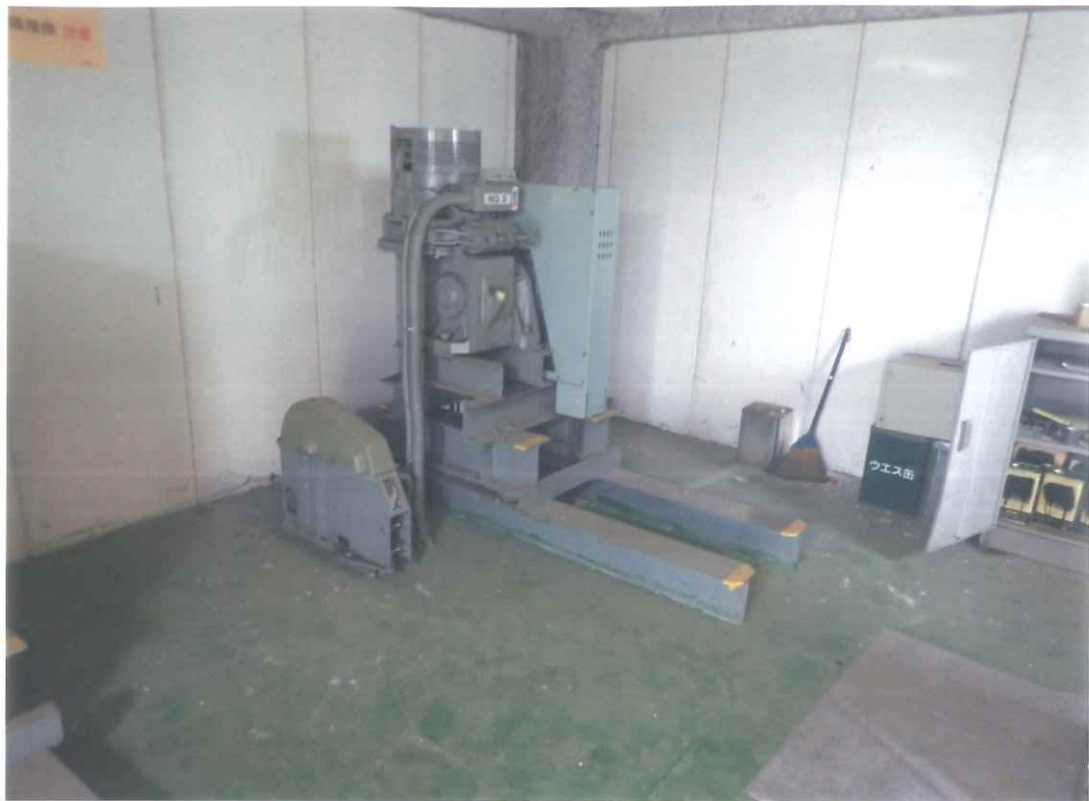
対象不動産の様子(EV機械室)
