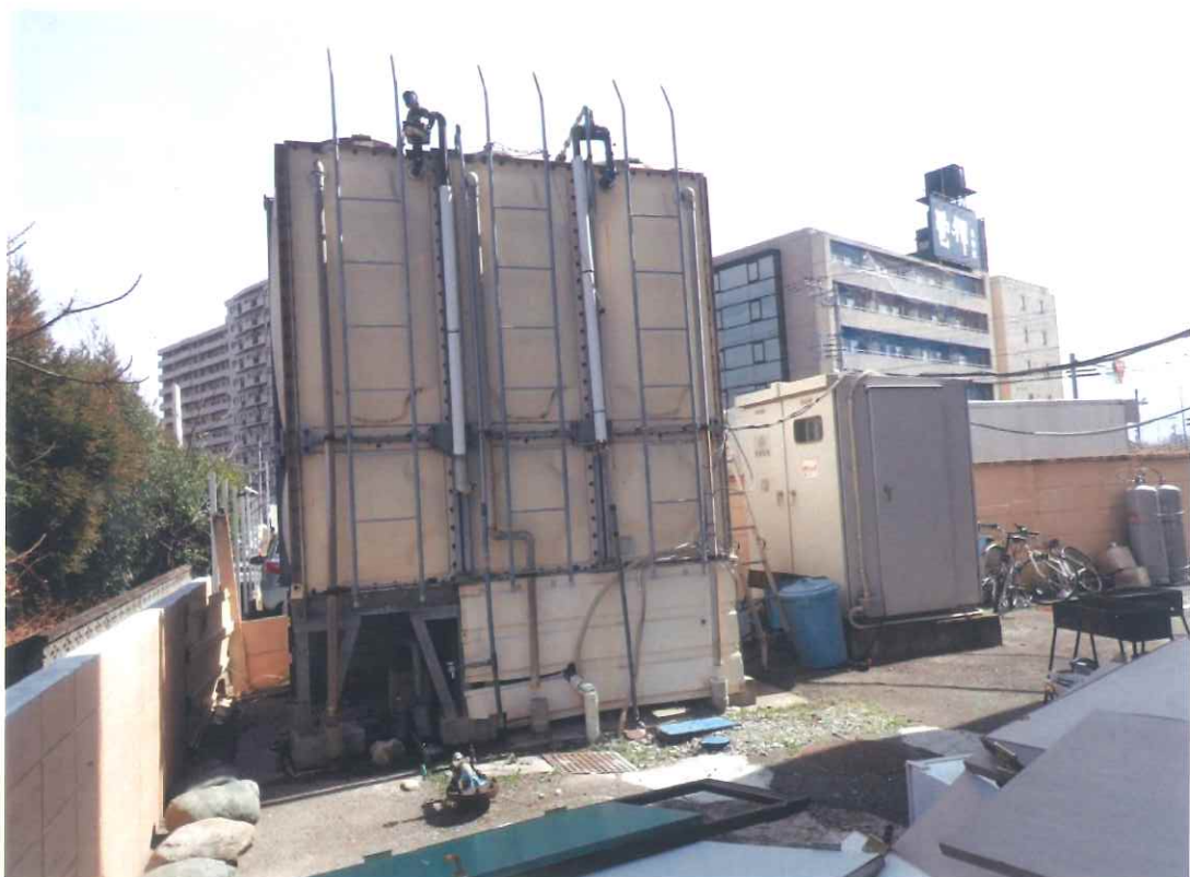
対象不動産の様子(受水槽・キュービクル)
