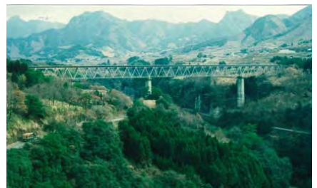
写真 2.20 透過性の高いトラス橋 ※参考文献 2-14 より（宮崎・高千穂橋梁）
