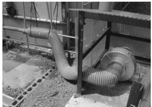
写真-13 吸引通気装置を備えた新堆肥舎と悪臭吸引用ブローワー
