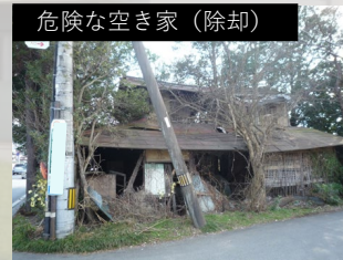
危険な空き家（除却）
