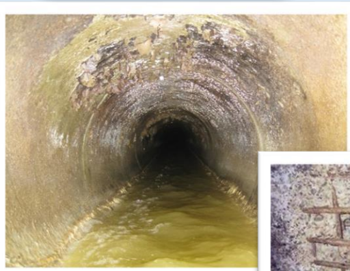
管路内の劣化状況
