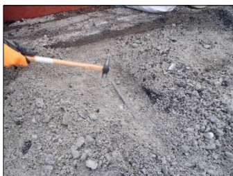
舗装下のコンクリートが劣化
