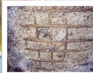
管路内の鉄筋露出
