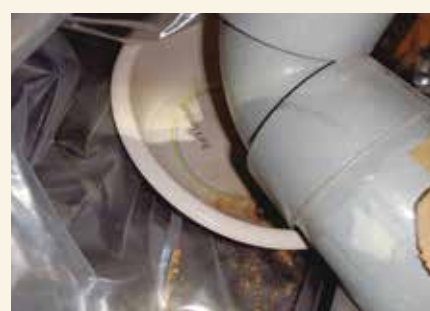
排水管の接合部からの漏水
