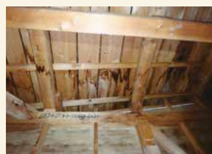
小屋裏(野地板)の雨染み跡
