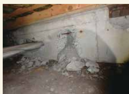
基礎の鉄筋露出(コンクリート爆裂)
