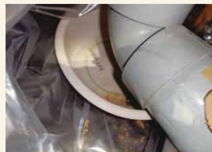
排水管の接合部からの漏水
