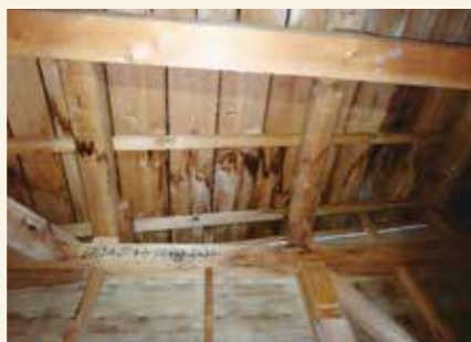
小屋裏(野地板)の雨染み跡
