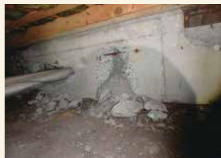
基礎の鉄筋露出(コンクリート爆裂)
