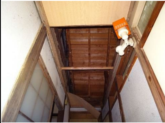
天井板の剥がれ
