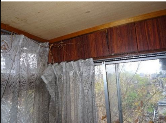
広縁の壁が東側に傾いている。補強・改修が必要。
