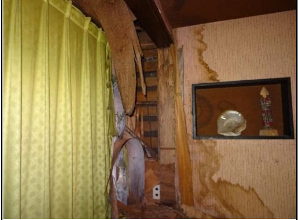
雨染み、壁・天井板の剥がれ
