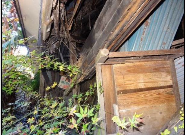
納戸(西側崩落部)
