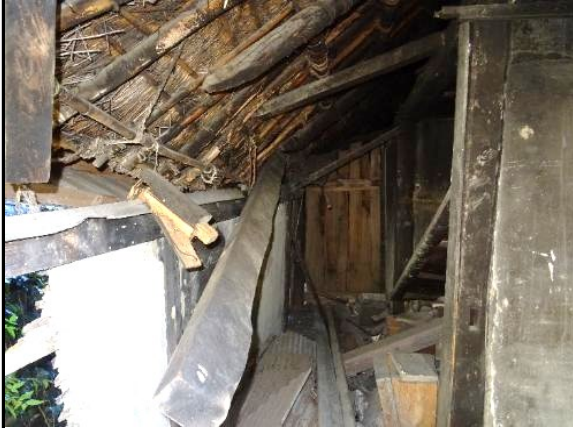
納戸(西側崩落部)
