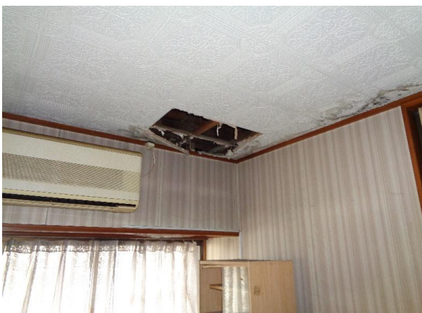
⑪天井水モレ箇所
