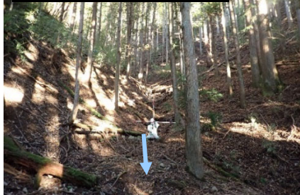
①荒廃状況(ダムサイト)
