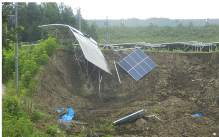
写真 2-4 傾斜地設置型太陽光発電設備の豪雨被害事例（4）写真提供：一般市民
