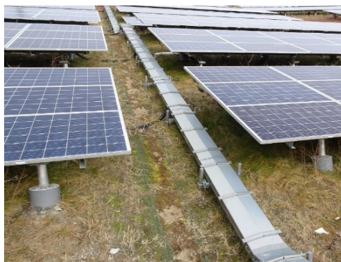
写真 13-1 ラックによる配線の例
