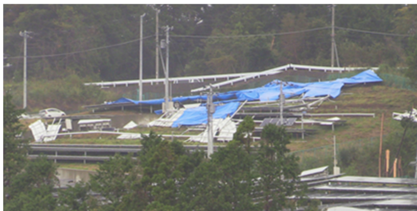
写真 2-5 傾斜地設置型太陽光発電設備の強風被害事例 写真提供：PVeye
