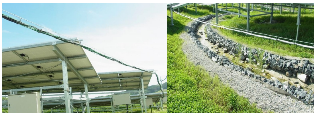
写真 13-2 架空配線の例
