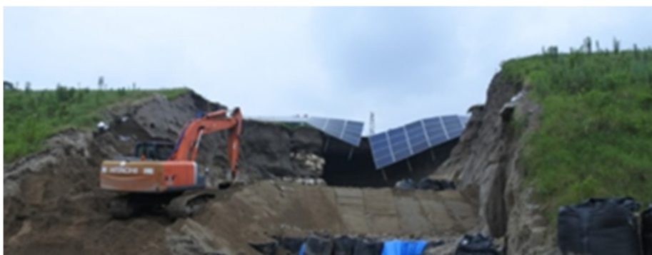
写真 2-2 傾斜地設置型太陽光発電設備の豪雨被害事例（2）
