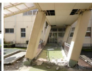
渡り廊下東棟の傾斜
