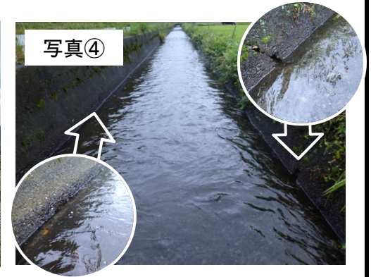
写真④ 水路の損傷が激しく、漏水が生じている。
