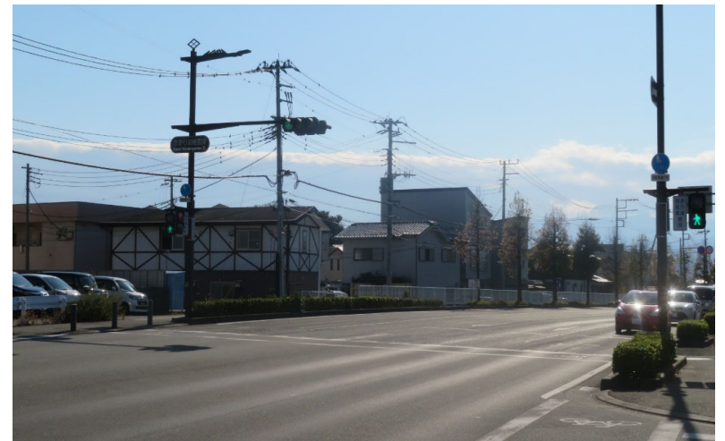
【写真②】災害時に倒壊の恐れのある電柱
