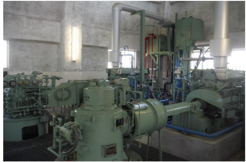
②現況のポンプ施設
