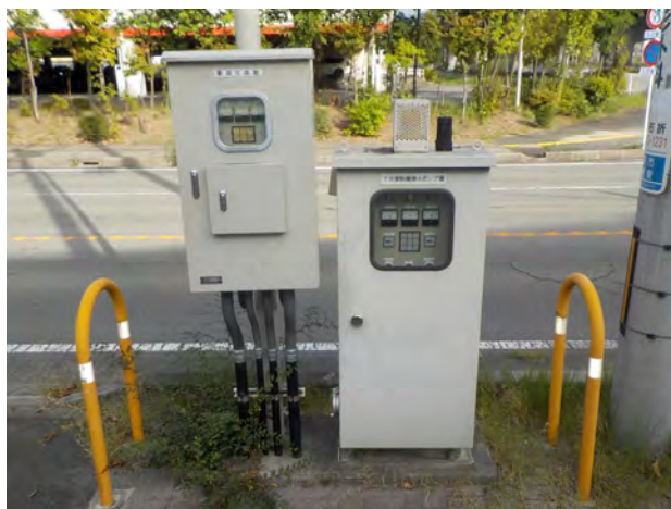
下河東幹線第4ポンプ場操作盤
