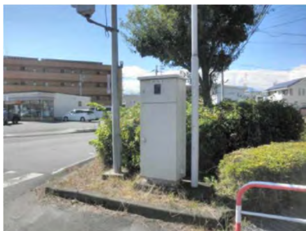
大里第一マンホールポンプ場
