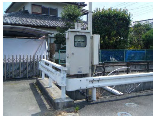
紙漣阿原マンホールポンプ場
