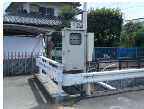
紙漉阿原マンホールポンプ場
