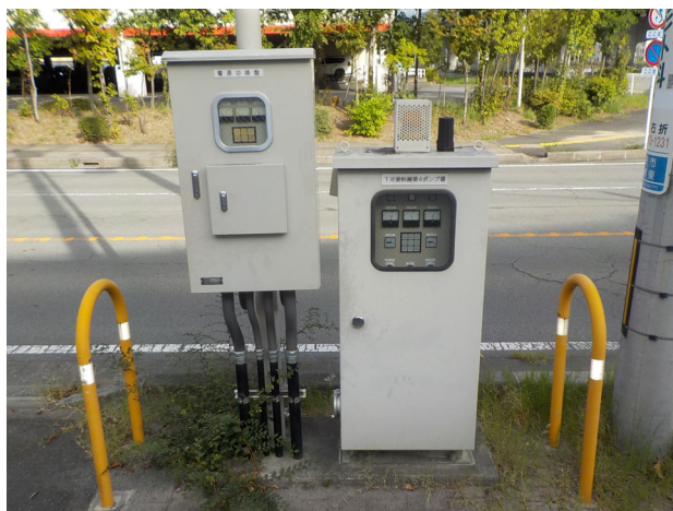
下河東幹線第4ポンプ場操作盤
