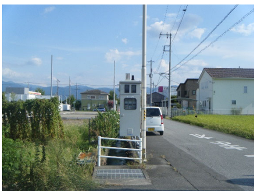
築地新居マンホールポンプ場
