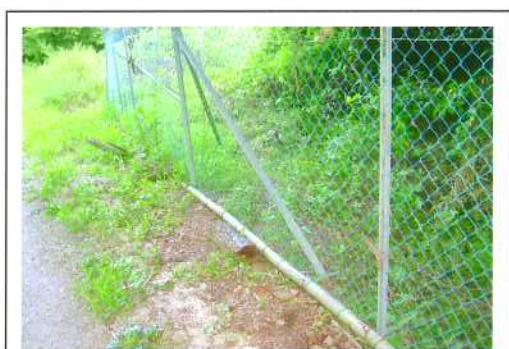
(写真1) 金属ネットの下から潜られないよう、竹を柵下にワイヤーで固定している。
