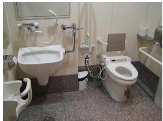
多目的（利用しやすい）トイレ
