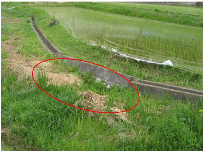
①老朽化により転倒し、水路が閉塞している。
