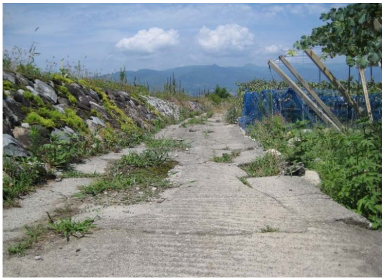
③農道の幅員が狭小で舗装が傷んでいる状況
