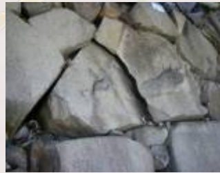
石材斜め破断補強
