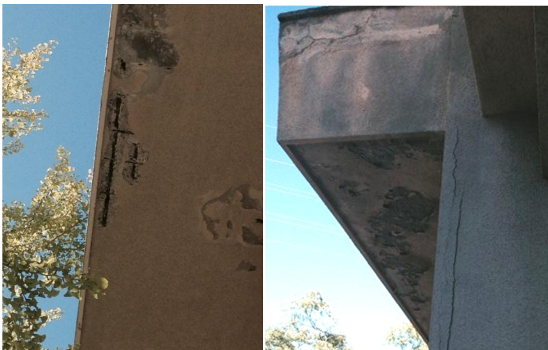
図IV 2 - 12 軒裏の鉄筋腐食（峡南高校／写真左）と、外壁モルタル層の浮き（増穂商業高校／写真右）
