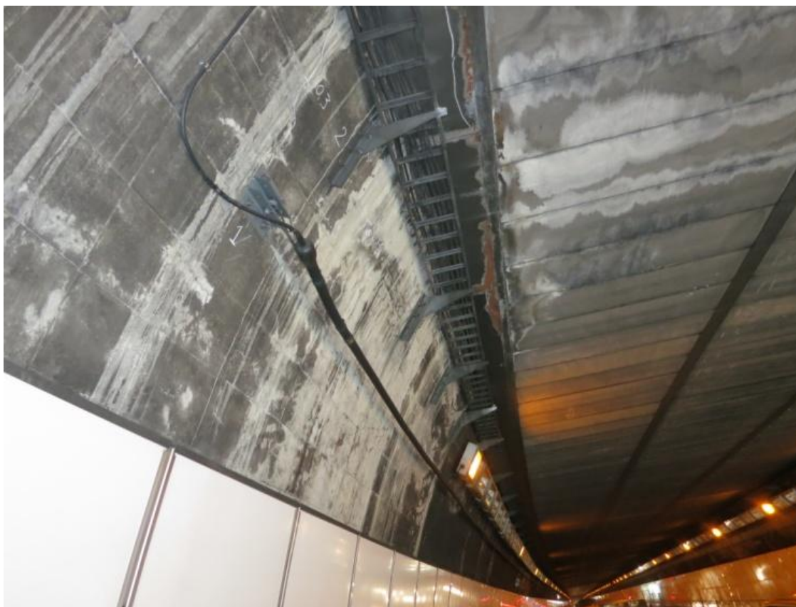
図Ⅲ-8 在来工法の施工による愛宕トンネルの坑口近くの側壁に見られる漏水跡 (ひび割れが起きていて、放置しておくとコンクリートやモルタルの剥落の恐れもある)
