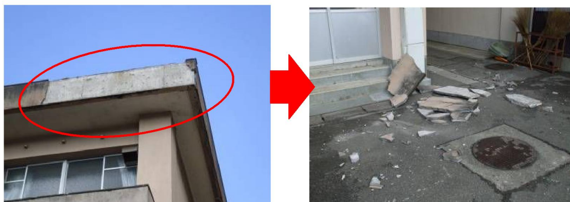
図IV 2 -13 外壁モルタル剥落の例
