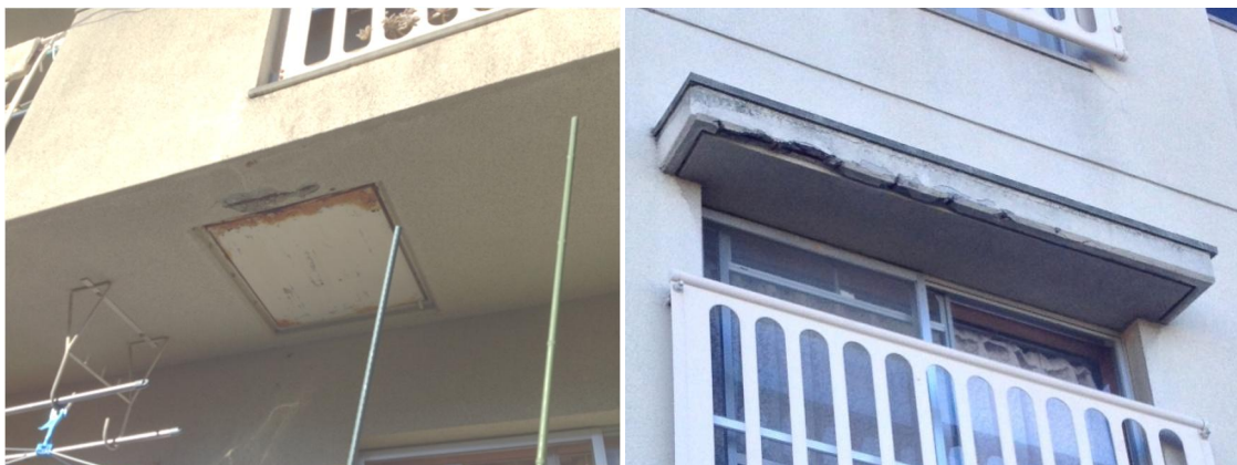
図Ⅳ１－９ 鯉沢北団地の庇部分の鉄筋腐食（左）と、バルコニー床開口（避難ハッチ）周りの鉄筋腐食（右）
