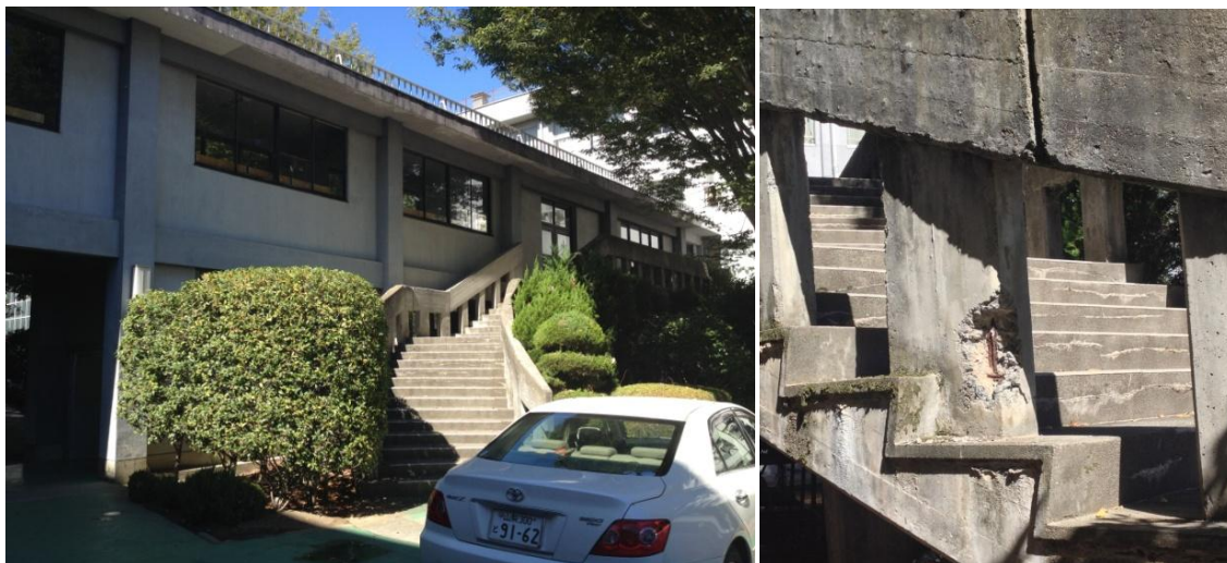
図IV 2 - 11 市川高校の施設の劣化事例
