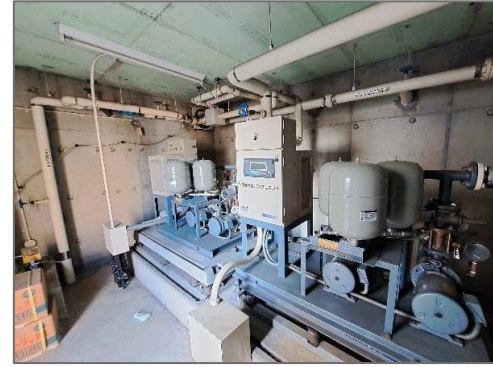
ポンプ小屋内部
